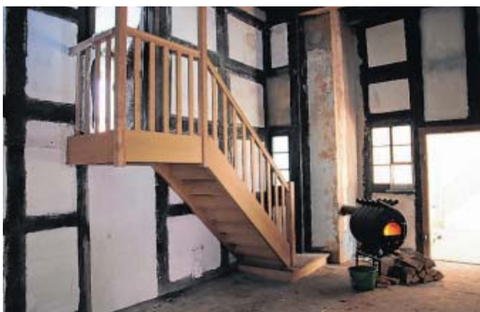
Alt und neu: Die Treppe, die in der Deele links in die oberen Räume führt, ist komplett ausgewechselt worden. Der schwarze Ofen ist nur gemietet, der Förderverein hat schon einen eigenen bestellt.
